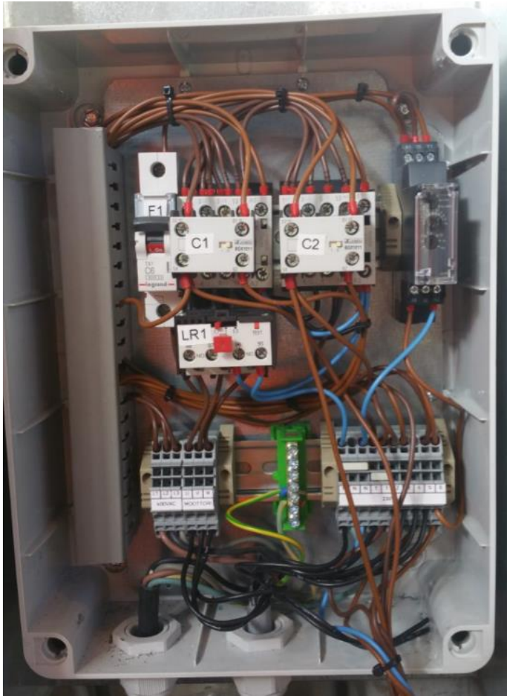
Kuva 7. Ohjauskeskus, muutostöiden jälkeen.
