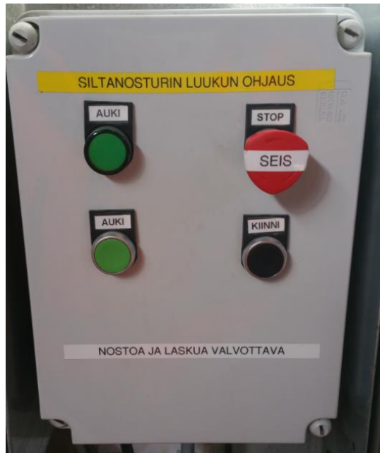
Kuva 6. Luukun ohjauskeskuksen kansi, jossa merkkivalo ja painonapit.
