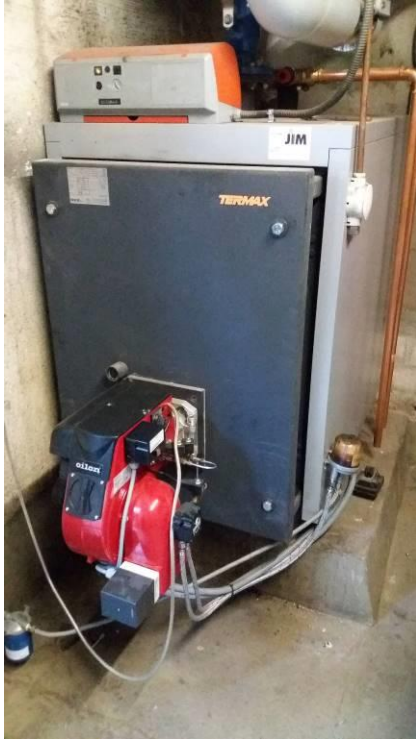
Kuva 14. Parikan kappelin öljykattila
