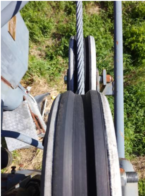
Kuva 5. Koltek hissien köysipyörä.
