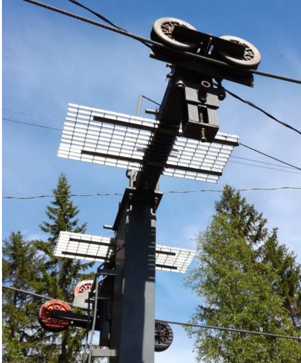
Kuva 10. 1. Pylvään nousupuolelta puuttuvat alapuoliset rullat.
