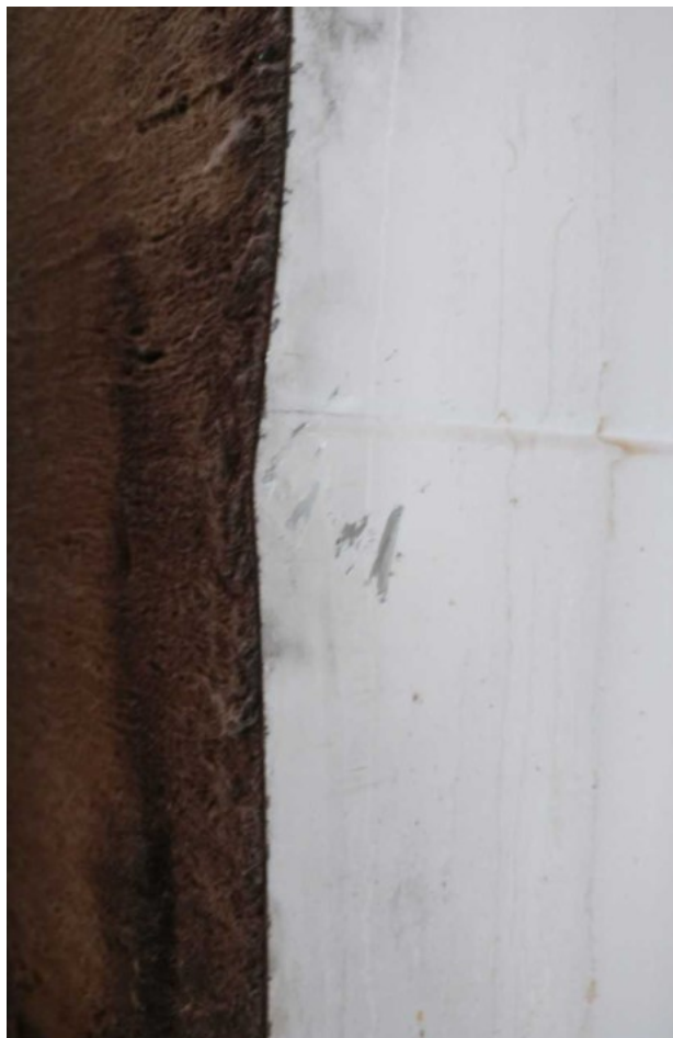
Kuva 15. Seinäelementtien sauma. Saumapelti on poistettu tarkastusta varten ja osoittautui, että sauman eristyksessä on puutteita. Lisäksi näkyvissä lieviä kosteuden aiheuttamia jälkiä (tummunut materiaali).
