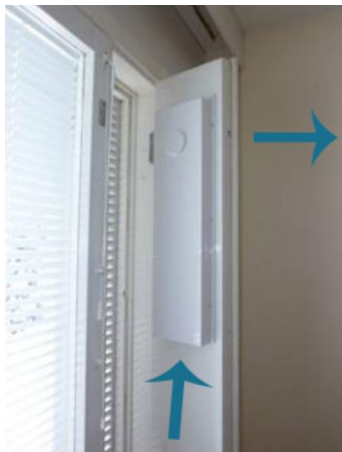
Kuva 41. Ääniloukku estää melun siirtymisen ulkoa sisätiloihin venttiilin kautta (terveysilma.fi).
