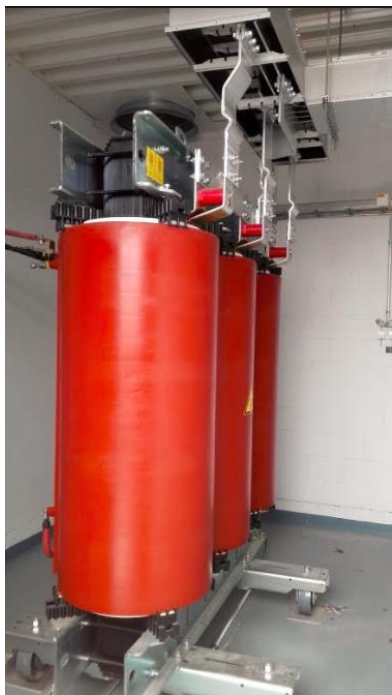
Kuva 32. KJ- muuntajat pumppaamossa
