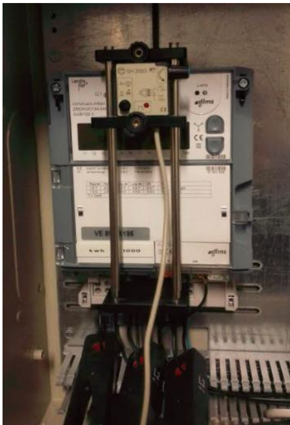
Kuva 34. Optinen valopää SH 2003 asetettuna kWh mittariin ja virtapihdit kytketty mittauspiiriin
