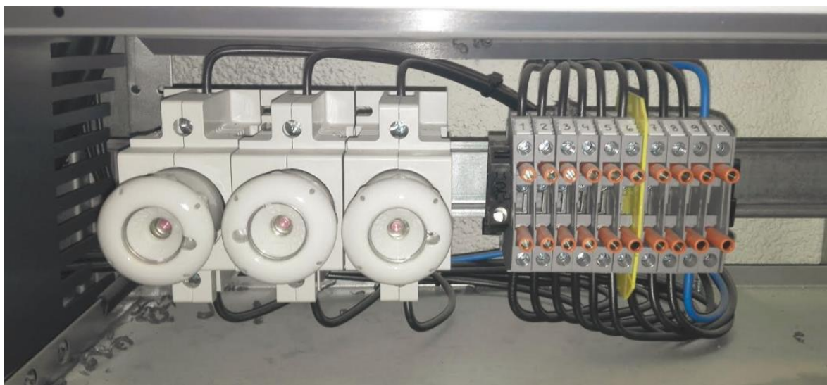
Kuva 15. Mittauksen etusulakkeet ja riviliittimet
