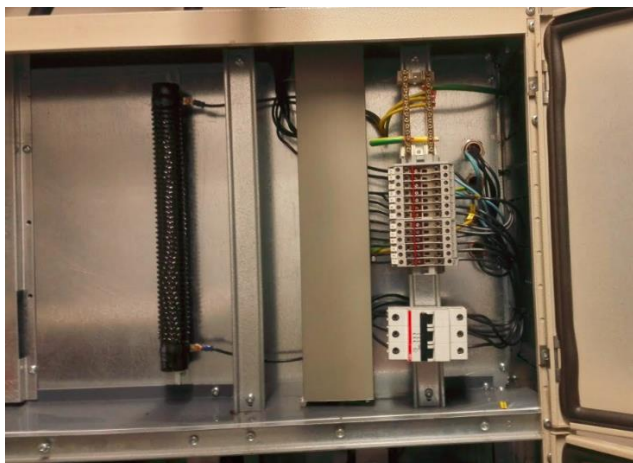
Kuva 31. Jännitemuuntajan vaimennusvastus, riviliittimet ja sulakkeet
