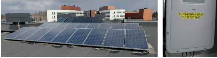
Kuva 5. Aurinkopaneelien sähköntuoton teholutut siirtyvät katolta langallisesti ohjausyksikköön LVI-konehuoneeseen ja siitä edelleen WLAN-verkossa koulun intranettiin.
