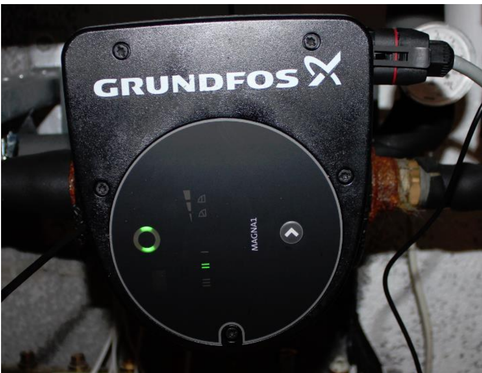
KUVA 12. Kiertovesipumppu Grundfos MAGNA1 25-80
