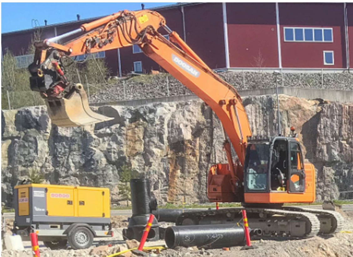
Kuva 7 Työssä käytetty kaivinkone sekä uppopumpun ja muiden sähkötyökalujen virtalähteenä käytetty dieselkäyttöinen generaattori (Kuva: Louhintahiekka)
