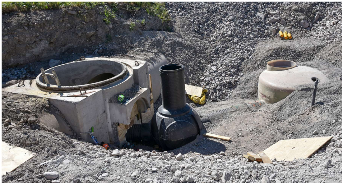
Kuva 10 Kaivo 3:n asentaminen on tehty ja ennen kuin päästään peittämään loppuun, pitää Lehdon tehdä betonimuotti loppuun ja valaa kuvassa näkyvä aukko betonilla umpeen. Kuvasta käy ilmi hyvin, kuinka kaivo liitettiin hulevesiviemäriin ja väliin asennettiin tarkastuskaivo. Huomaa myös betoninen hulevesiviemäri, josta vanha haara on poistettu kokonaan ja lisäksi on jouduttu laajentamaan aukkoa. Kuvan ottamisen jälkeen muotti tuplattiin ja valettiin. (Kuva: Louhintahiekka)
