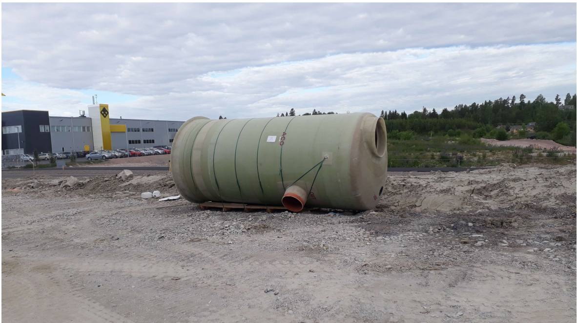
Kuva 11 Kaivo 1 kuljetuslavansa päällä muutamaa hetkeä ennen asennusta. Kaivon suuresta koosta huolimatta se asennettiin kaikista pienimmällä ryhmällä ja ilman uppopumppua ja aggregaattia. Kaivannon kaivamiseen meni kahdessa aikaisemmassakin asennuksessa käytetyn kanssa samanlaiselta koneelta kaksi päivää, koska puomin pituus ei riittänyt kaivamista suoraan määräsyvyyteen. Lisäksi itse asennuksen piti tapahtua nopeasti, jotta kaivanto ei olisi täyttynyt vedellä ja mahdollisesti jopa sortunut kesken asennustyön. (Kuvan otti Teemu Björkbacka)
