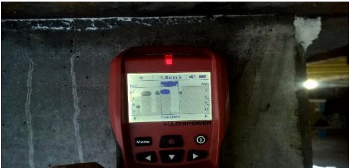
Kuva 12 Pilarin betonipeitteen koemittaus. Kuvassa betonipeitettä on ainoastaan 10mm, vaikka suunnittelijan määrittämä betonipeitteen minimivaatimus oli vähintään 35m
