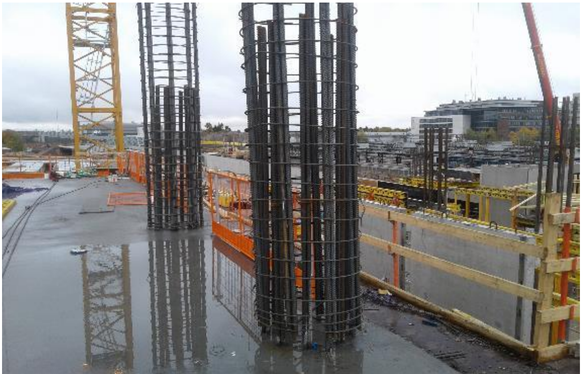
Kuva 9 Pilarihäkit jatkoksien varassa
