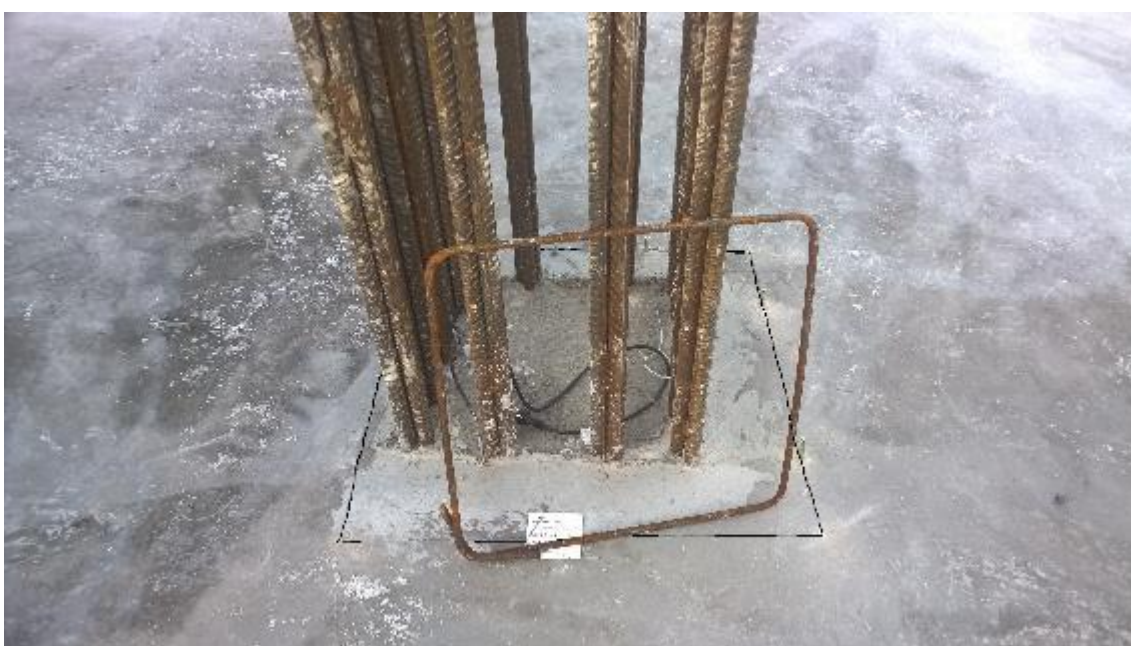
Kuva 10 Pilarien raudoitukset väärässä sijainnissa
