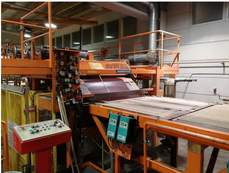
KUVA 3. Pinnoituslinjan syöttöpää ja stasisointilaitte
