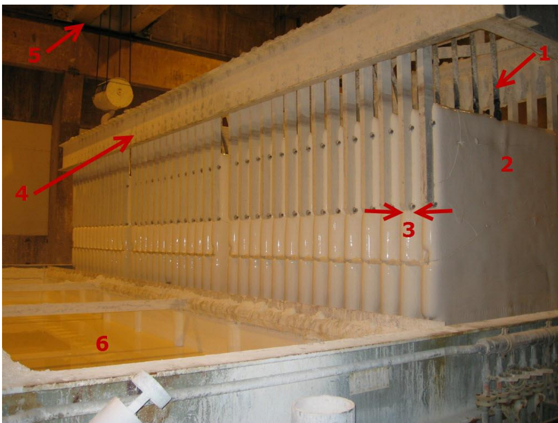
Kuva 2. Moore-kehikko, johon on alipaineen avulla suodatettu kakut: 1. imuputki 2. kakku 3. suodinlehti 4. kehikko 5. siltanosturi 6. suodatusallas (Venator Powerpoint - materiaali)
