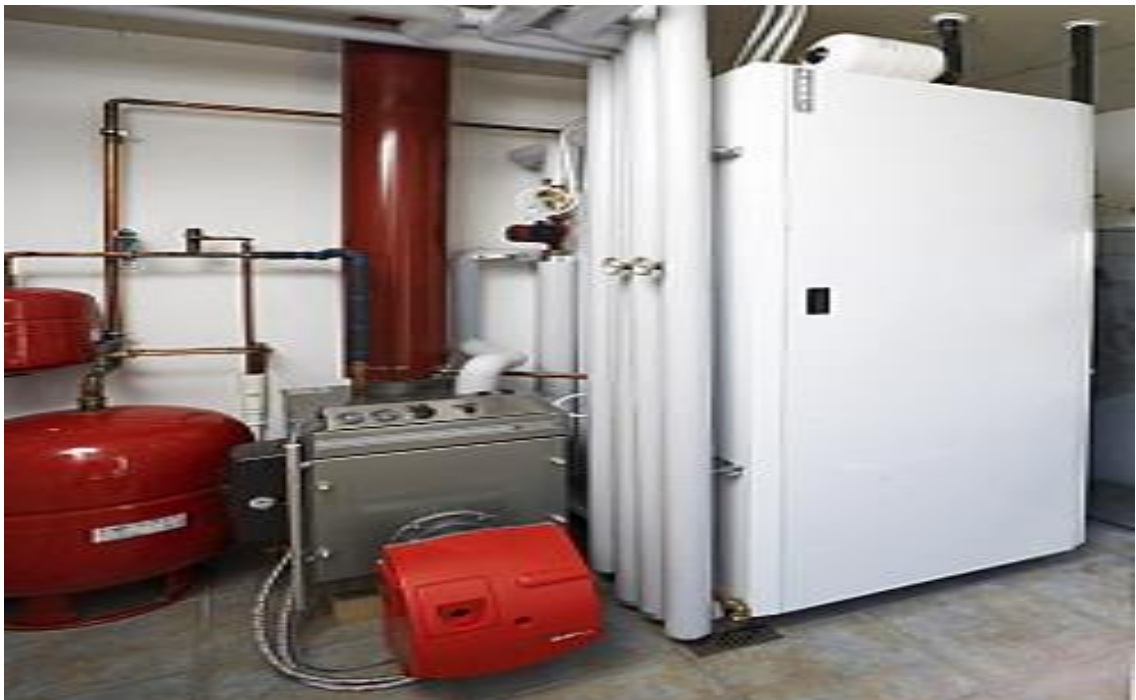
Kuva 4. Aurinko-Öljy -järjestelmä teknisessä tilassa [6].
