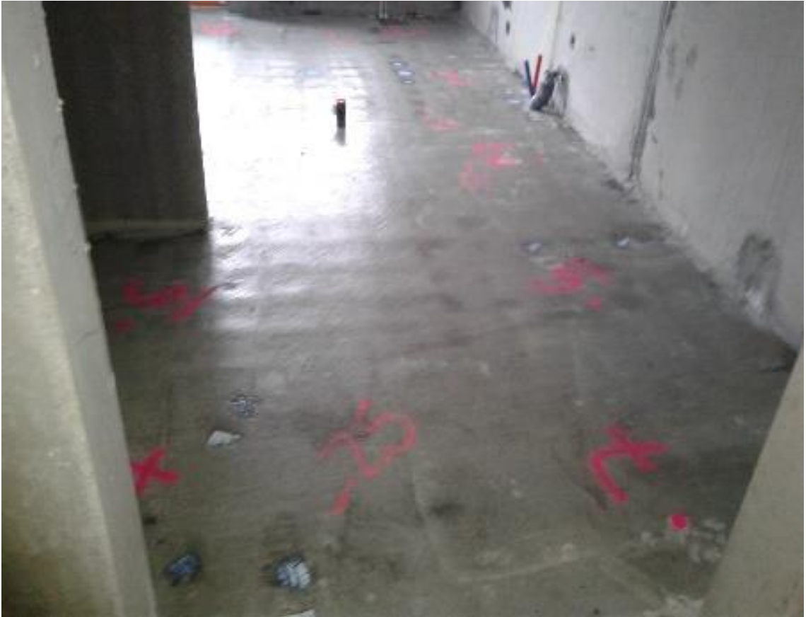
Kuva 40. Työläs ja kallis pintabetonointi 2–25 mm (Forselius, A. 2018)
