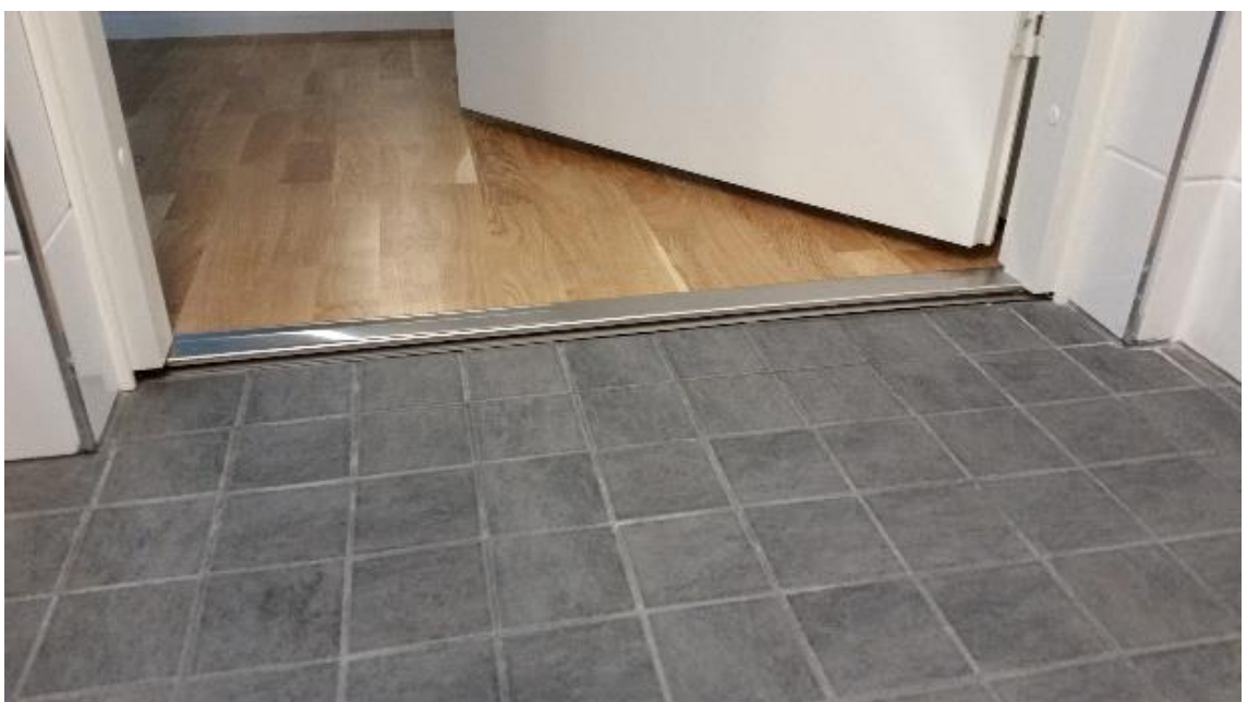
Kuva 15. Pesuhuoneen kynnyks, PH (Forselius, A. 2018)
