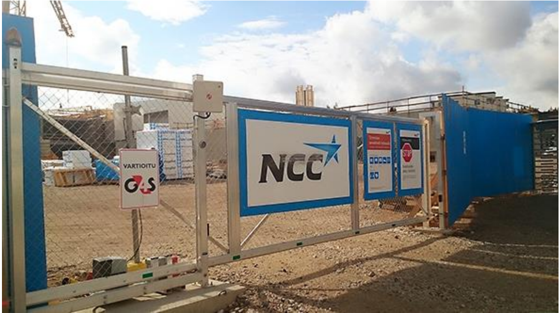
Kuva 11. Työmaan sähköinen liukuportti ajoneuvoliikenteelle
