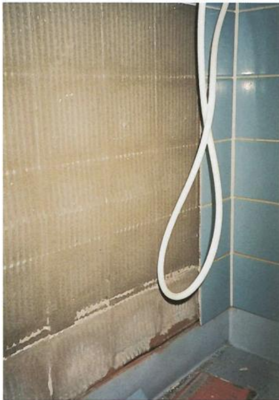
Kuva 3. Vedeneristeen ja maton seinälle noston irtoaminen toisistaan (Pitkäranta 2016, 170)
