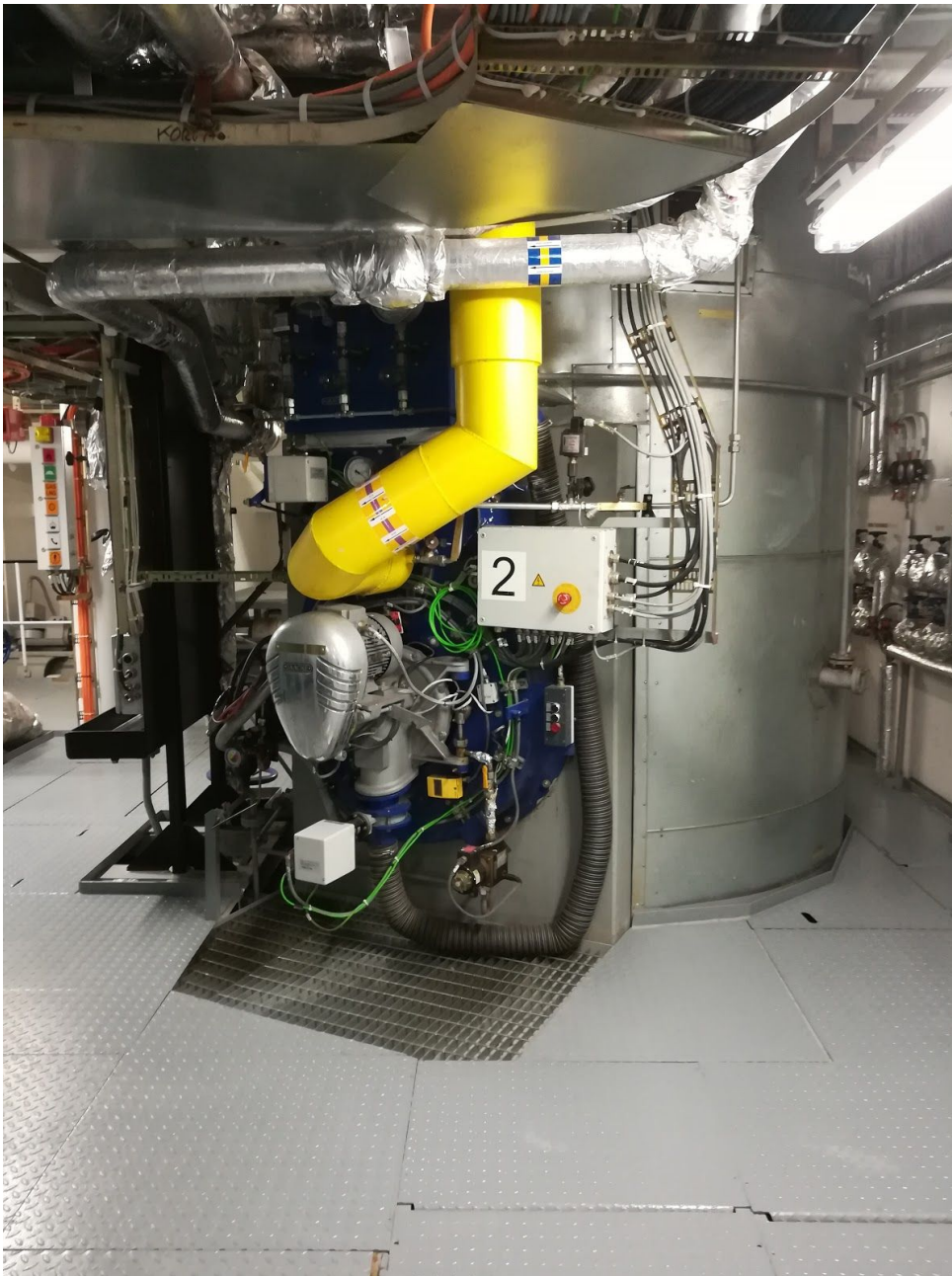
Figur 3. En av fartygets två pannor.
