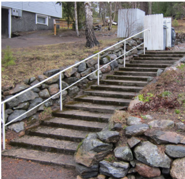
Kuva 15. Esimerkki pientalon jäteastian sijoituksesta portaiden yläpäähän, jolloin siirto alas aiheuttaa työturvallisuusriskin. (L&T 2017)
