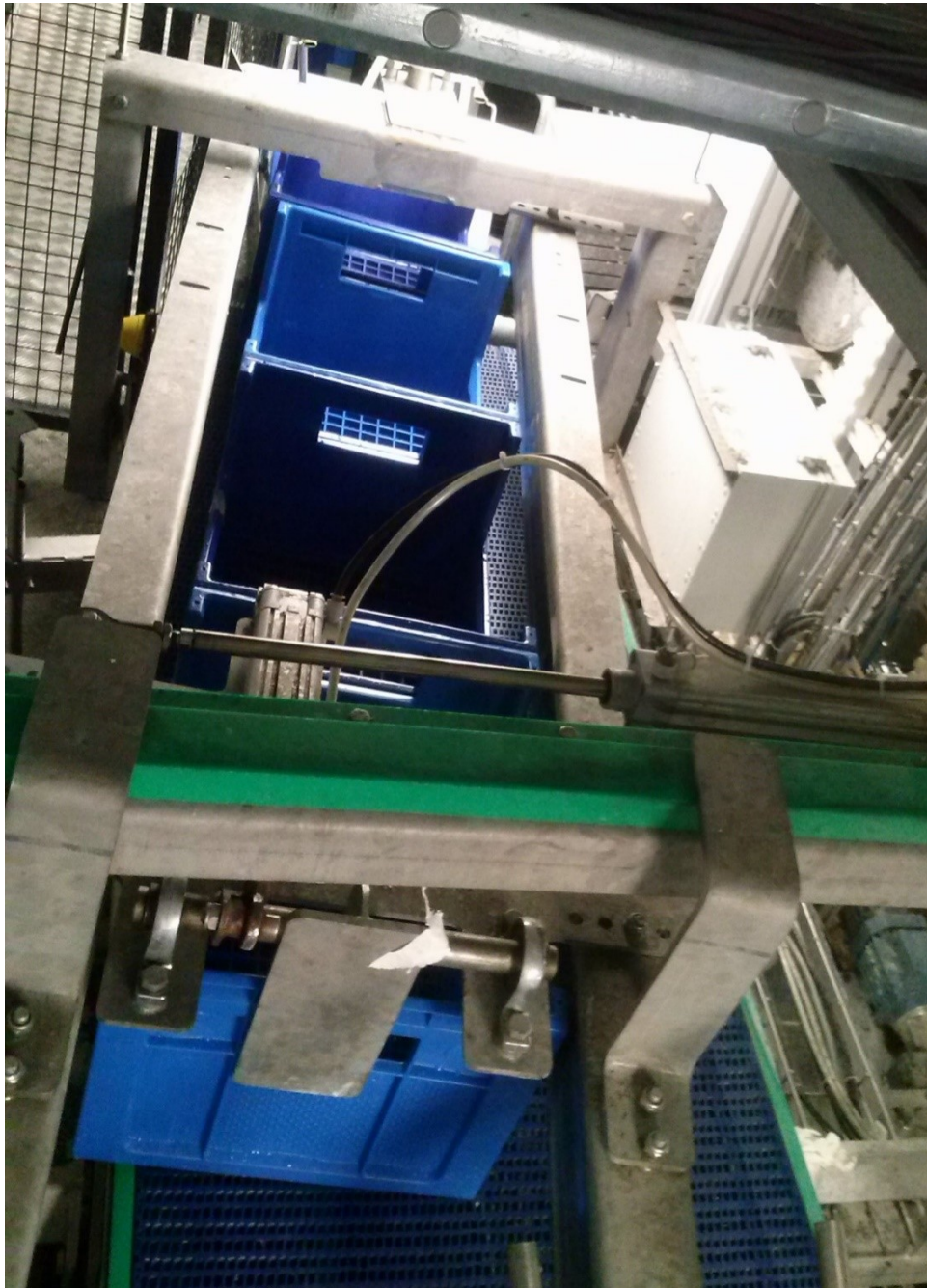
Kuva 9. Laatikkojakaja jakaa laatikoita jälkipakkauskoneille. (Kuva: Kuortti, 2018)
