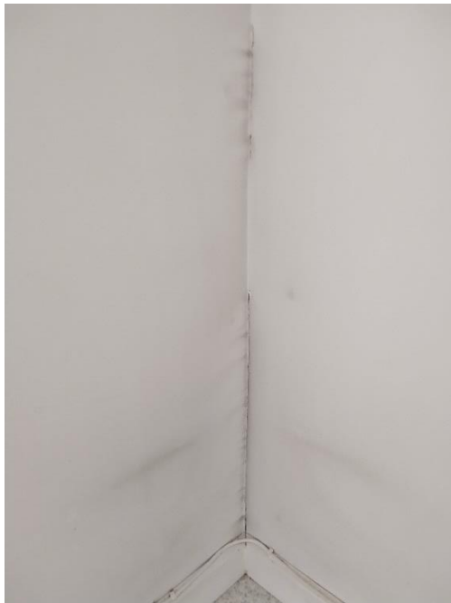
Kuvio 11. Kuhilas ulkoseinän ilmavuoto
