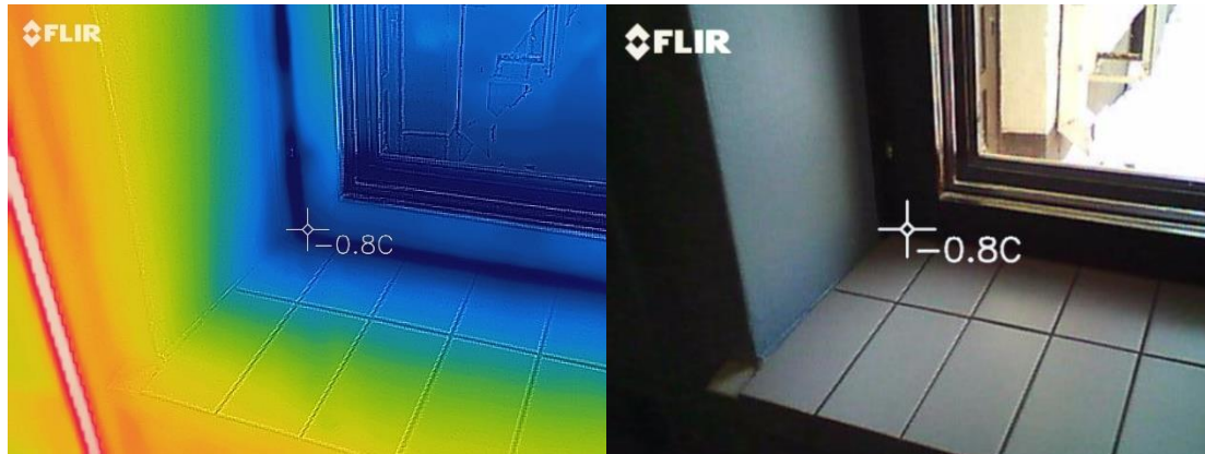
Kuvio 29. Lämpökuva Rantatie ikkuna
