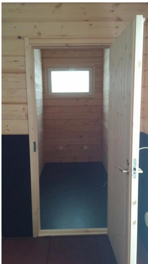
Kuva 13. Duo36 hevonen ja poni -valmistallin hoitotilasta näkymä varustetilaan. Kuvasta käy ilmi korvausilmaventtiilien sijainti.
