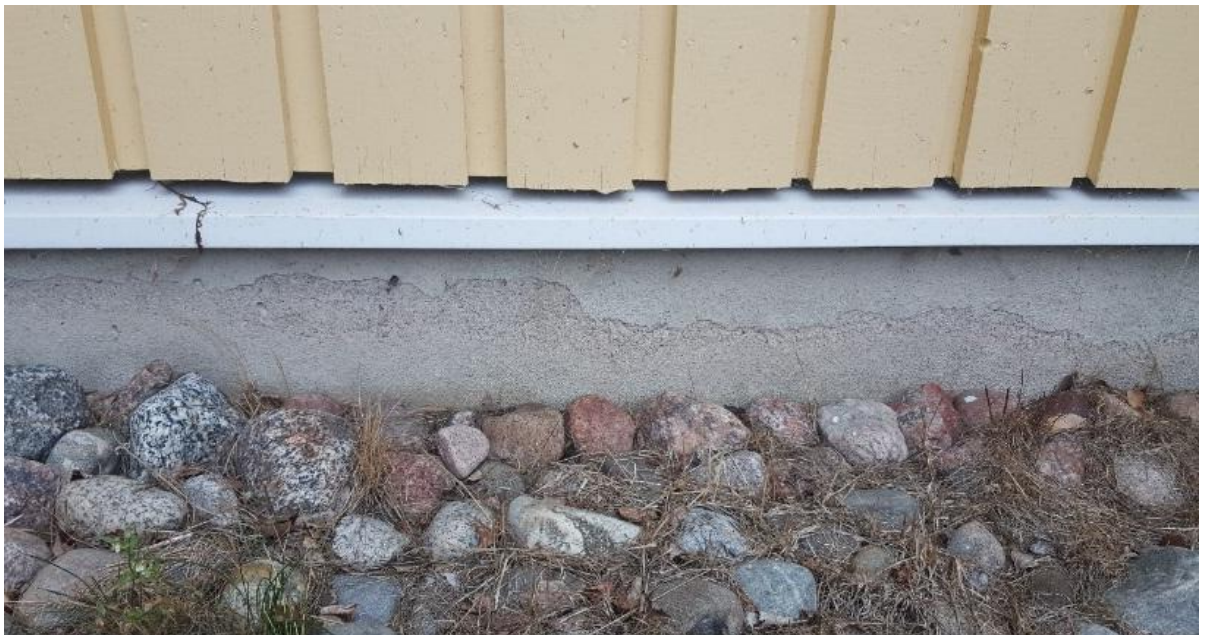
Kuva 5. Sokkelissa havaittavissa pinnoitteen irtoamista.
