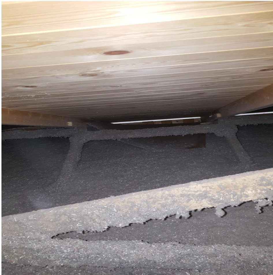
Kuva 7. Yläpohjan tuuliohjaimet irronneet.
