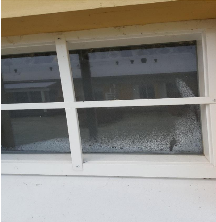
Kuva 10. Ikkunaan kerääntynyt kosteutta.
