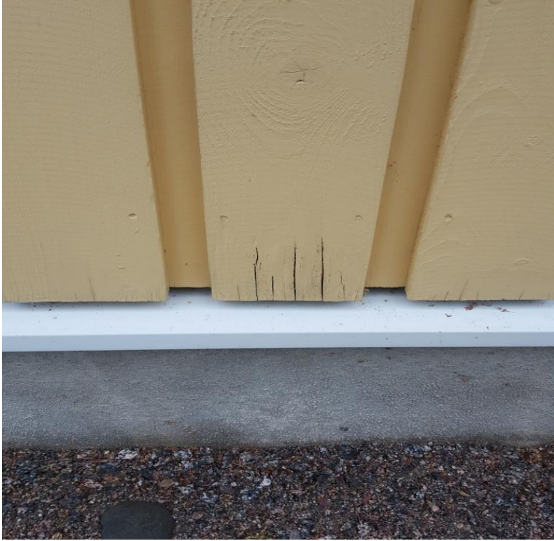
Kuva 8. Julkisivun lomalaudoitukset haljenneet.
