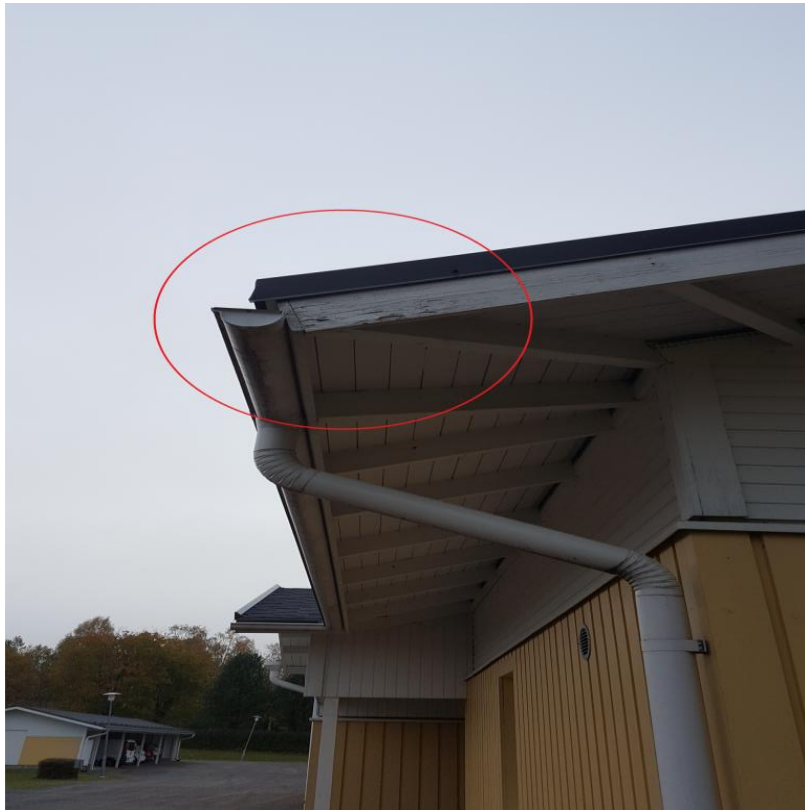
Kuva 9. Otsalautojen maalipinta hilseillyt ja haljennut.
