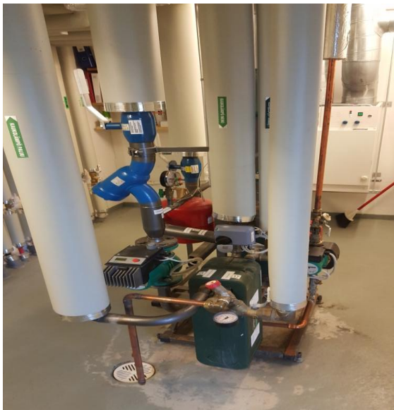
Kuva 14. Kaukolämpö meno- ja paluuputket.
