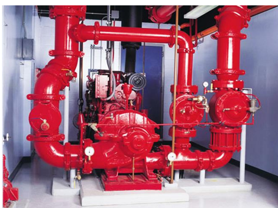
Kuva 10. Patterson Sentinel HS-pumppu ja pumppaamon putkisto [21].
