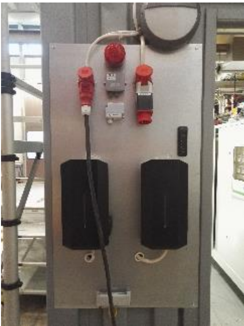
KUVA 9. Kontin liitännät sähköverkkoon ja sähköautojen latauspisteet
