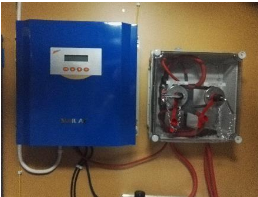
KUVA 6. Tuulisähkön lataussäädin ja akuston turvalaitteet
