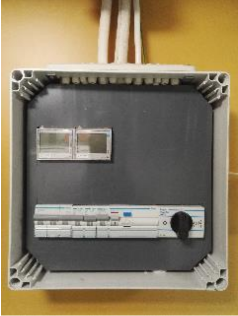
KUVA 11. Sähköautojen latauksen sähkökeskus
