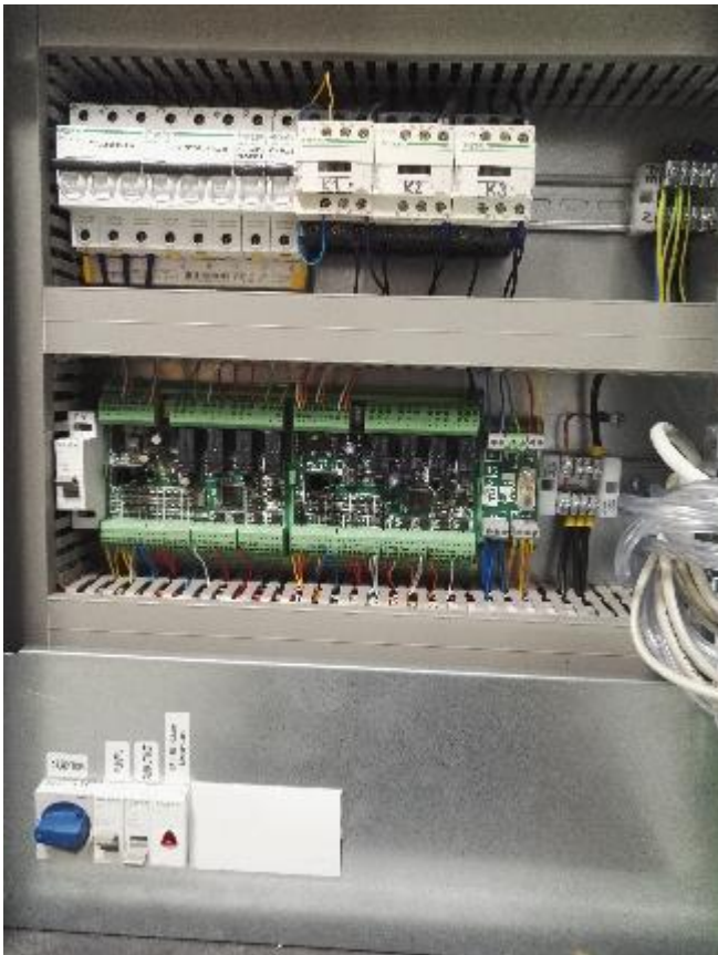
KUVA 7. RTEK Z500 sähkökytkennät
