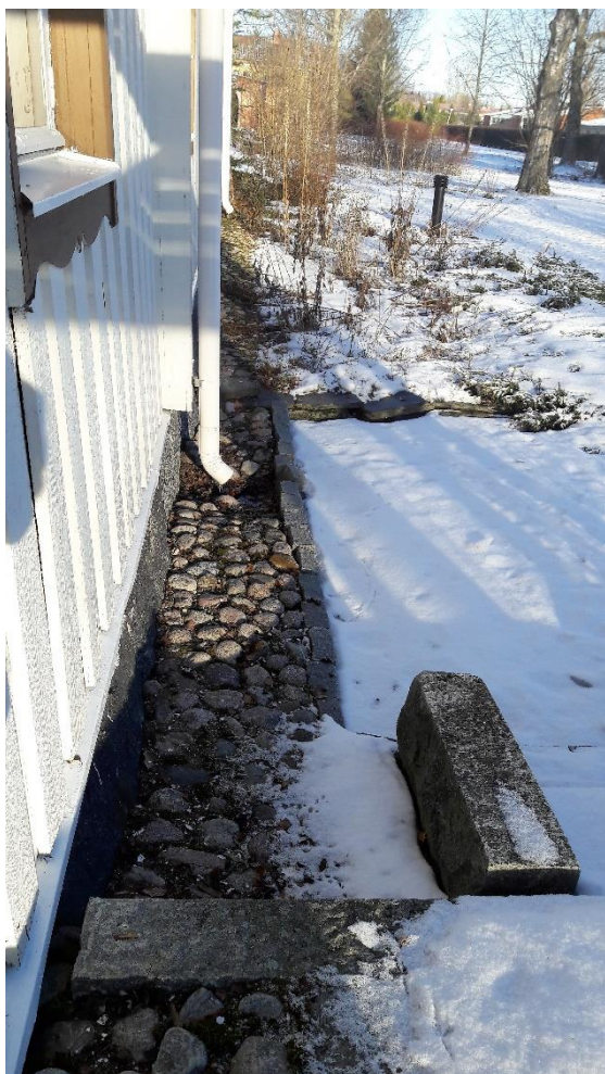
Kuva 14. Kartanon takapihan istuskelualueen vieressä oleva kenttäkiveys, liian alhaalle asennettu sadevesikaivo ja vinoon painunut nupukivireunus. (Kuva: Elina Ojanen, 2017.)
