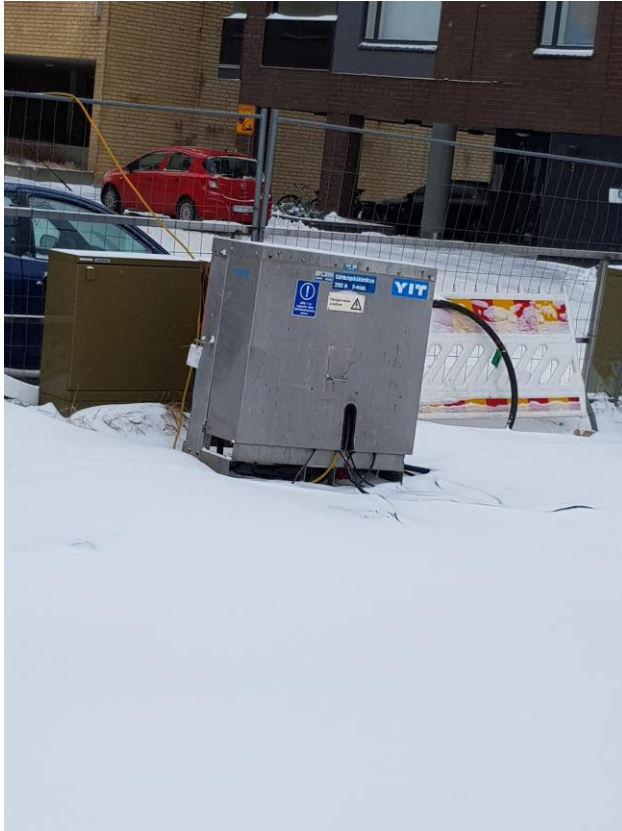
KUVA 2. Työmaan sähköpääkeskus 250 A (Bärholm)
