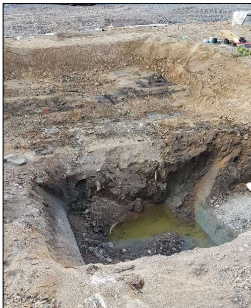
Kuva 1. Lähtötilanne, jolloin vahva polttoaineen haju havaittiin ensimmäisen kerran.
