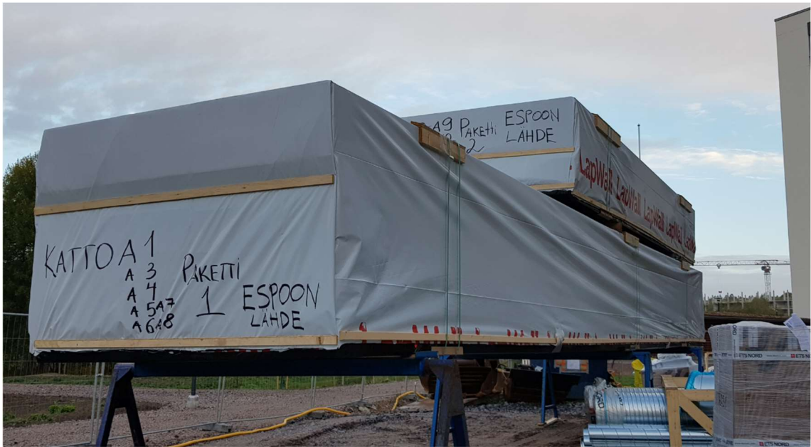
Kuva 7. Lähteen A-lohkon vesikattoelementit saapuivat työmaalle suojatuiissa nipuissa asennusjärjestyksessä ja varastoitiin pukkien päälle (Salopelto 2018).
