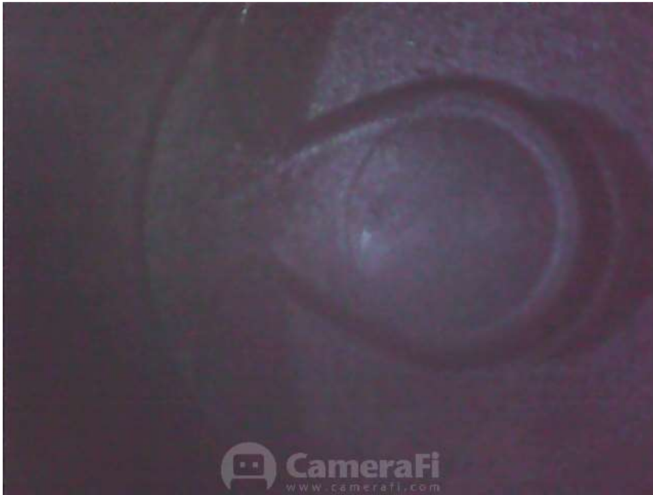
KUVA 32. Palotila ennen puhdistusta
