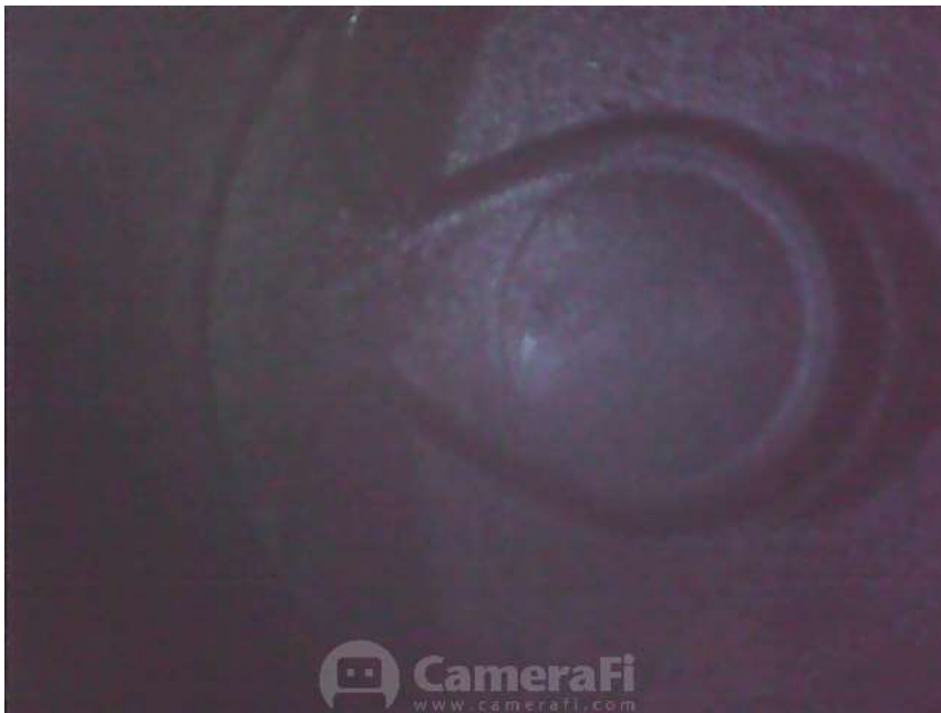
KUVA 31. Palotila ennen puhdistusta.
