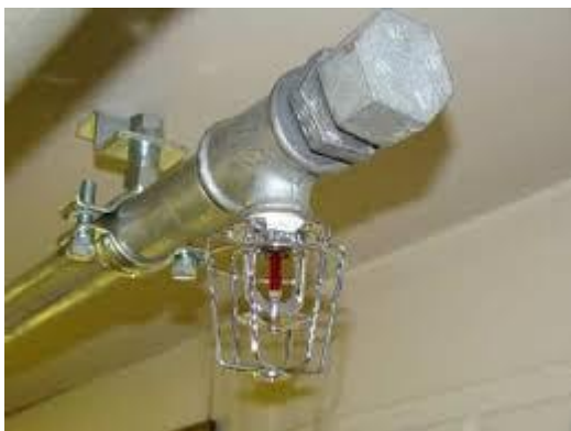
Kuva 1 sprinklerisuutin ja putkisto.
