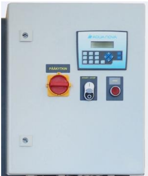
Kuva 15. Aquanovan käänteisosmoosilaitteiston ohjausyksikkö [36].
