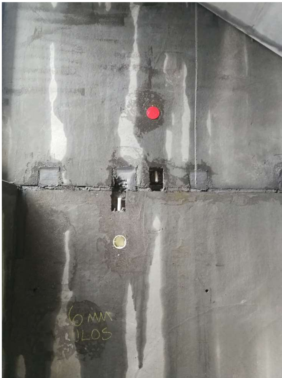
Kuva 23. Varaukset eivät osu kohdakkain, joten putkitusten jatkaminen vaatii betonin urittamista.
