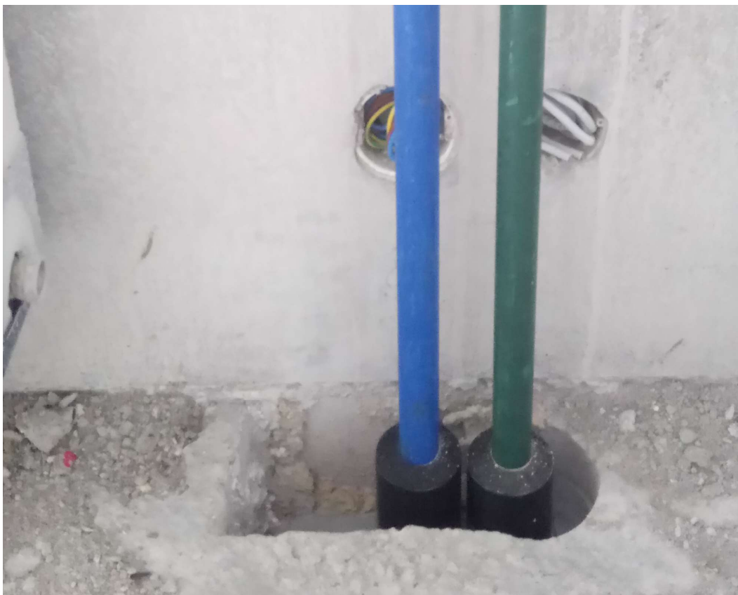
Kuva 24. Patteriputkiston ja kojerasioiden ristiriita.
