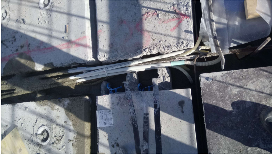
Kuva 14. SUR-varauksen putkitukset työmaalla. Tätä toimintatapaa tulisi välttää, koska putket ovat päällekkäin ja kiinni toisissaan.
