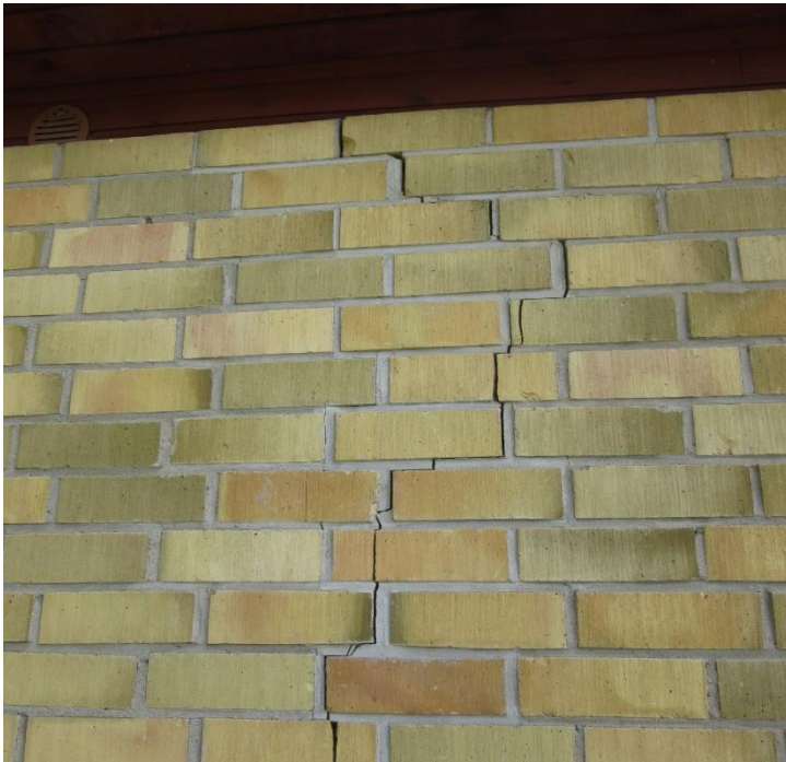
KUVA 12. Halkeama poltetuista tillistä muuratussa julkisivussa (7)
