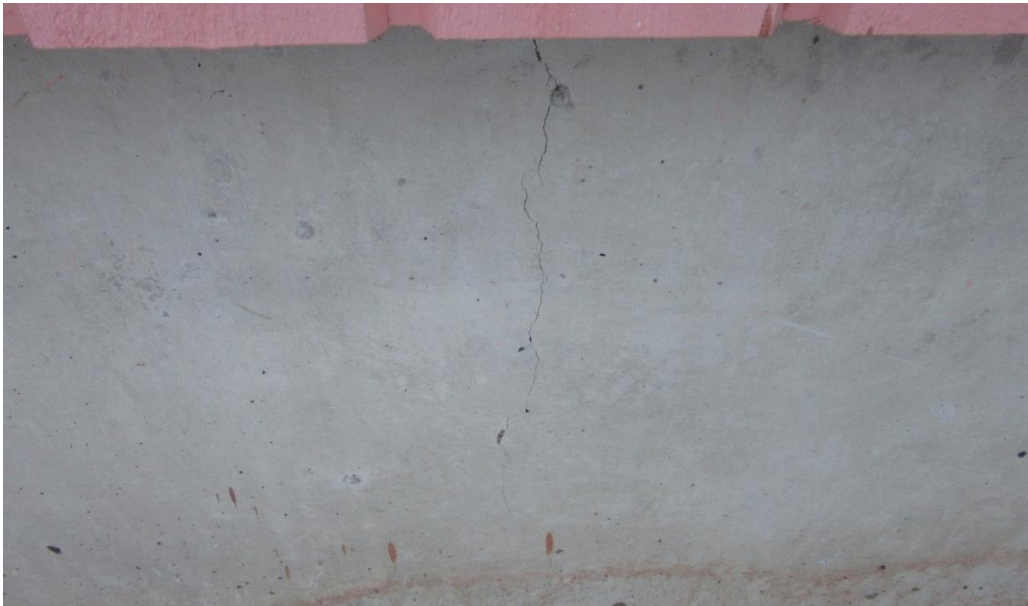
KUVA 13. Betonisessa perusmuurissa oleva hiushalkeama (7)
