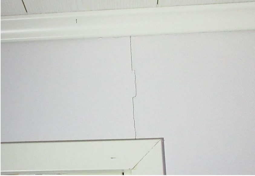
KUVA 14. Sisälevytyksen saumakohdassa oleva halkeama (7)
