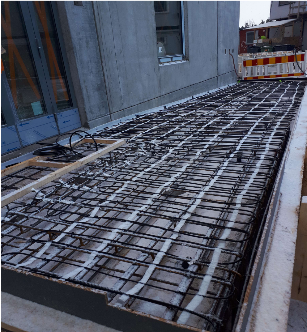
Kuva.3 Henkilökunnan sisäänkäyntirakennuksen sisäänkäyntiluiskan lämmityskaapelit.
