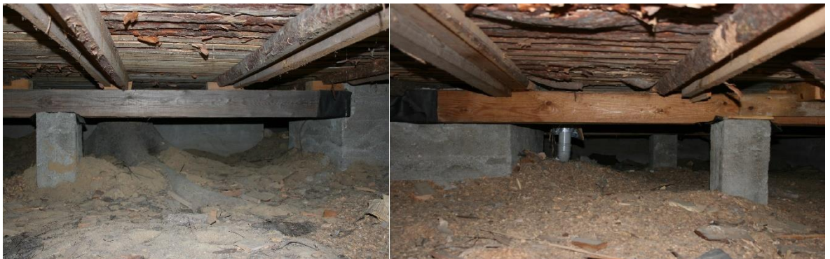
Kuva 7. Alapohjassa nähtävillä kanto ja eristämätön viemäriputki.
