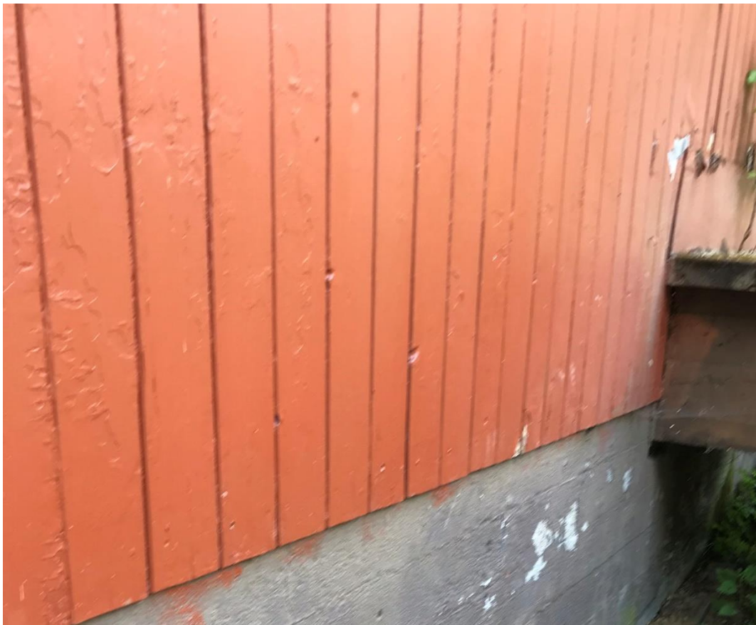
Kuva 5. Vanhaa maalia ei ole poistettu ennen huoltomaalausta
