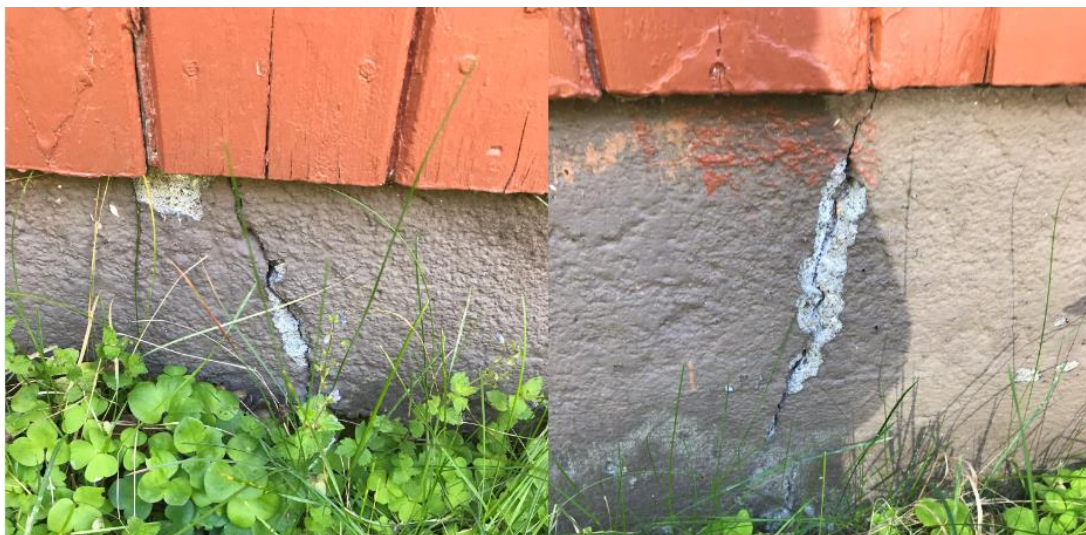
Kuva 4. Perustuksista löydetyt halkeamat.
