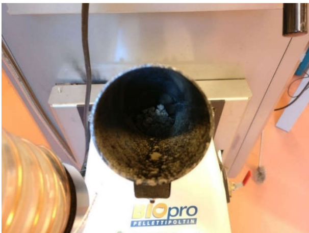
Kuva 25. Tukos polttoaineen syöttöputkessa
