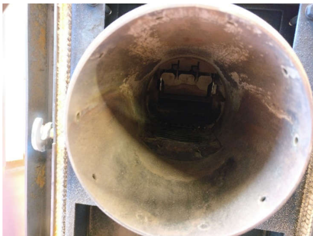
Kuva 14. Poltinputken perällä näkyy polttoaineen syöttöaukko, ohjausluukku ja arina
