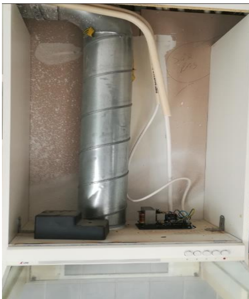
Kuva 15. Kohdepoistokanavan irronnut sähköteippitiivistys ja rikkoutunut liesituulettimen moottori. Syynä rikkoutumiseen voi olla sähkövika tai kanavasta päässyt kosteus.
