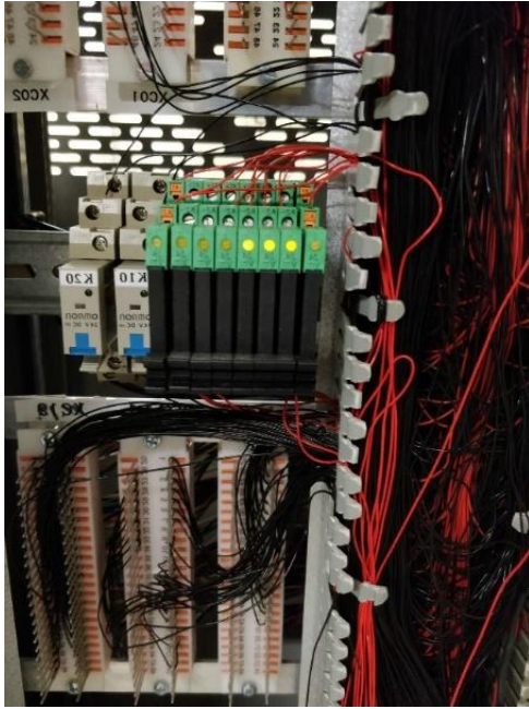
KUVA 5. Esimerkkikuva toisen automaatiokaapin optoerottimesta, jota ohjataan 2JA51 kautta
