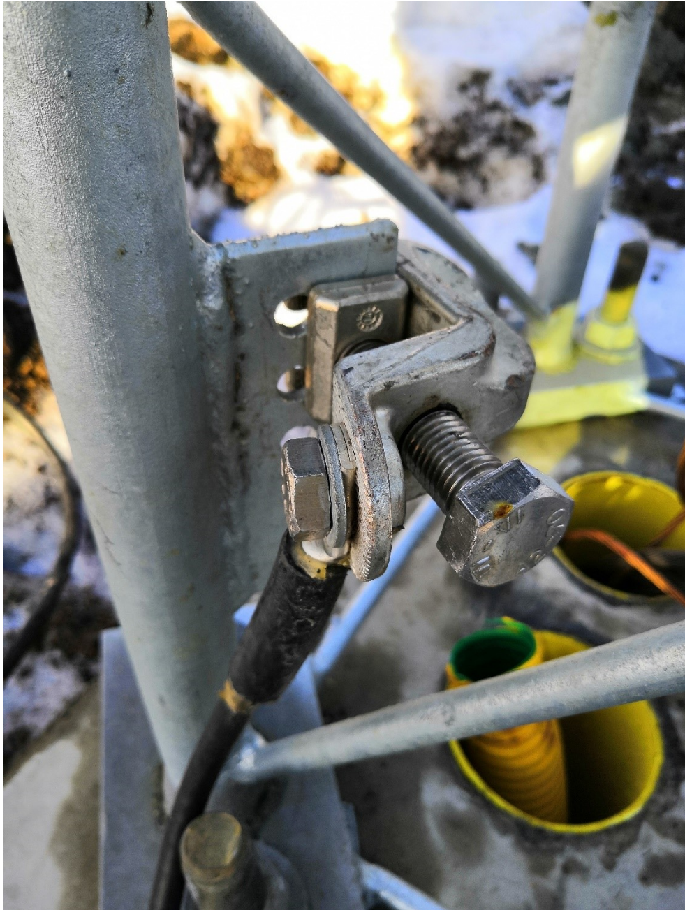
Kuva 17. Tilapäinen maadoitus valoheitinmastopylväässä
