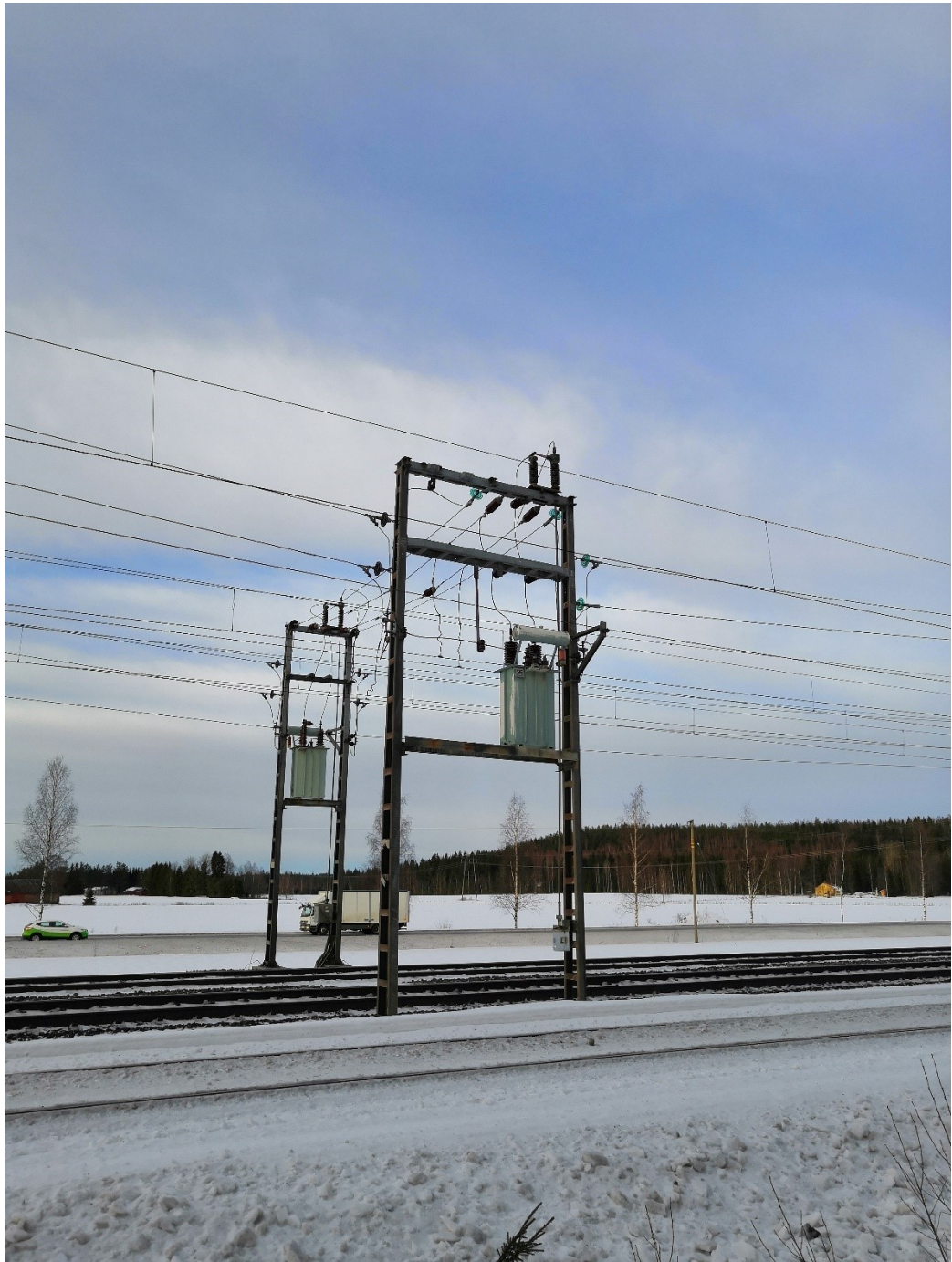
Kuva 8. Kaksiraiteisen osuuden imumuuntajat
