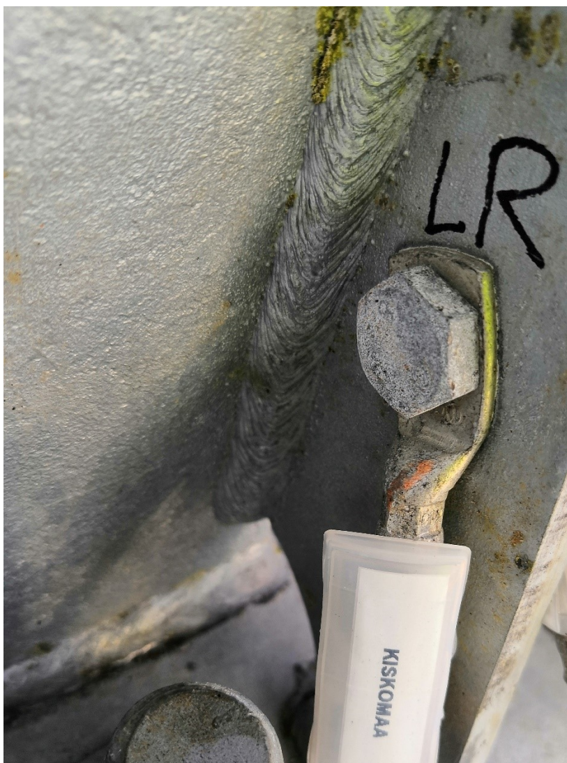
Kuva 19. Väliaikaisen maadoituksen pylväsliitäntä
