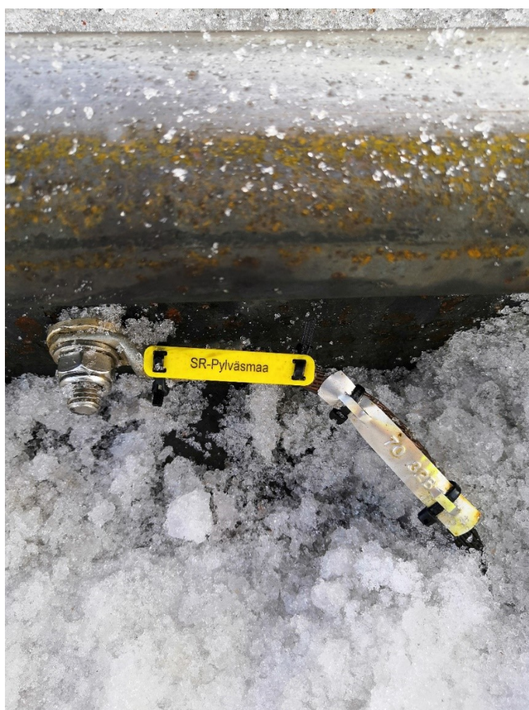
Kuva 15. Sähköratapylvään suojamaadoitus paluukiskossa.
