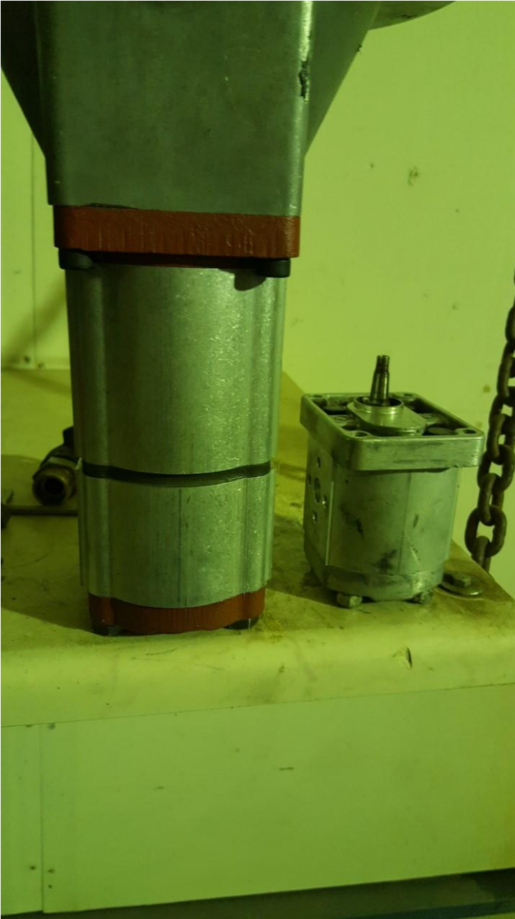
KUVA 16. Uusi pumppu vanhan vierellä (Ohvo 12/2018)
