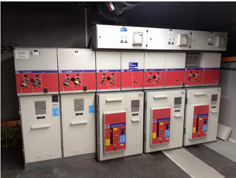
KUVA 5. VEI-yhtiön valmistama keskijännitekojeisto
