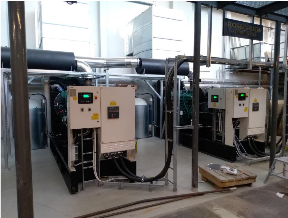
KUVA 9. Voimalaite Servicen toimittamat 600 kVA:n generaattorit
