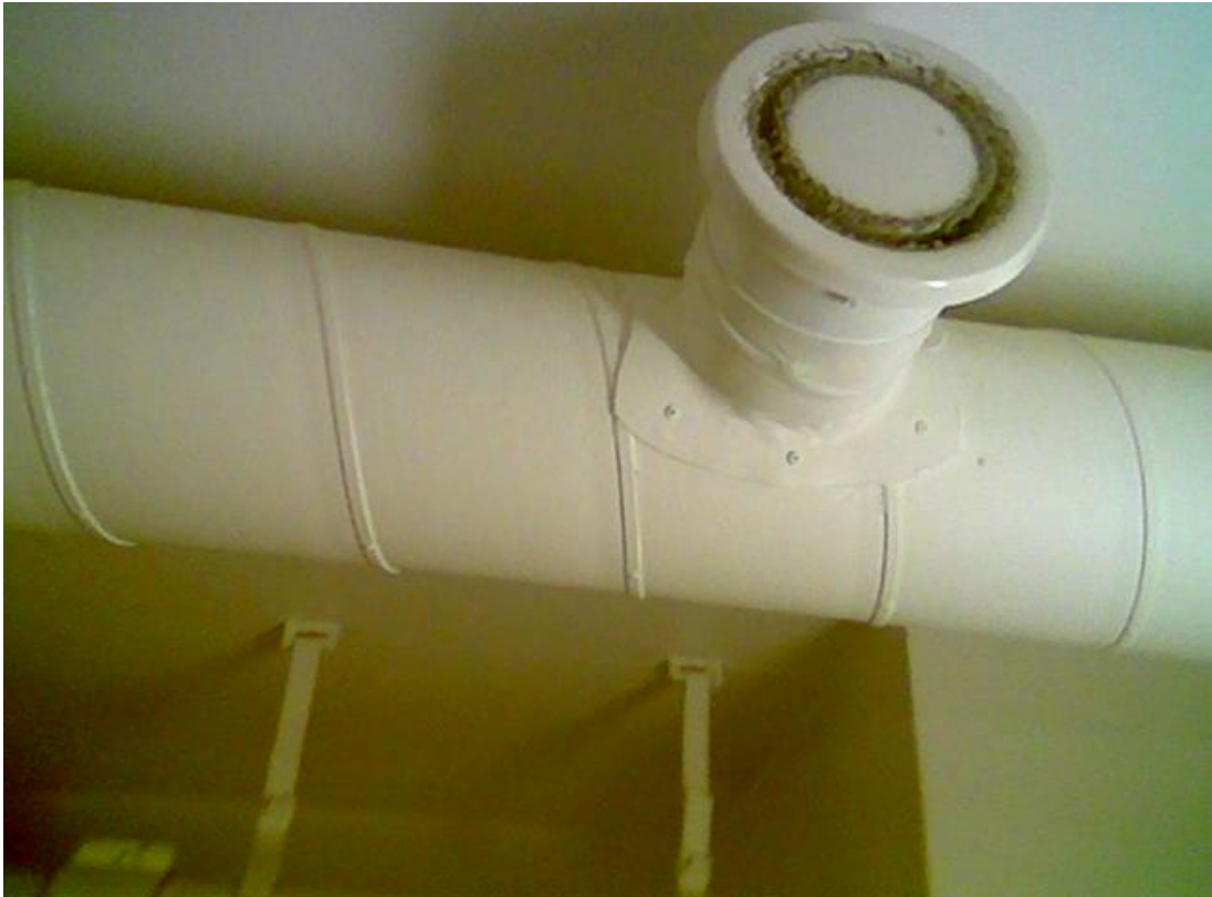
Kuva 5. Erittäin likainen poistoilmaventtiili.
