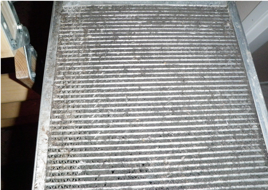
Kuva 4. Asuntokohtaisen IV-koneen likainen LTO-kuutio menossa puhdistukseen. Kuva on kennon poistopuolelta suodattimen takaa.
