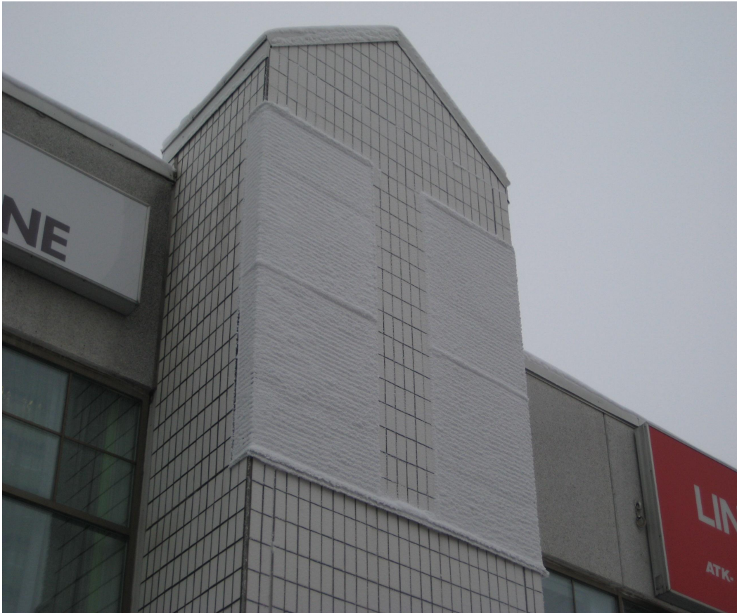
Kuva 3. Talvella lumi ja jää voivat tukkia ulkosäleikköjä (12).
