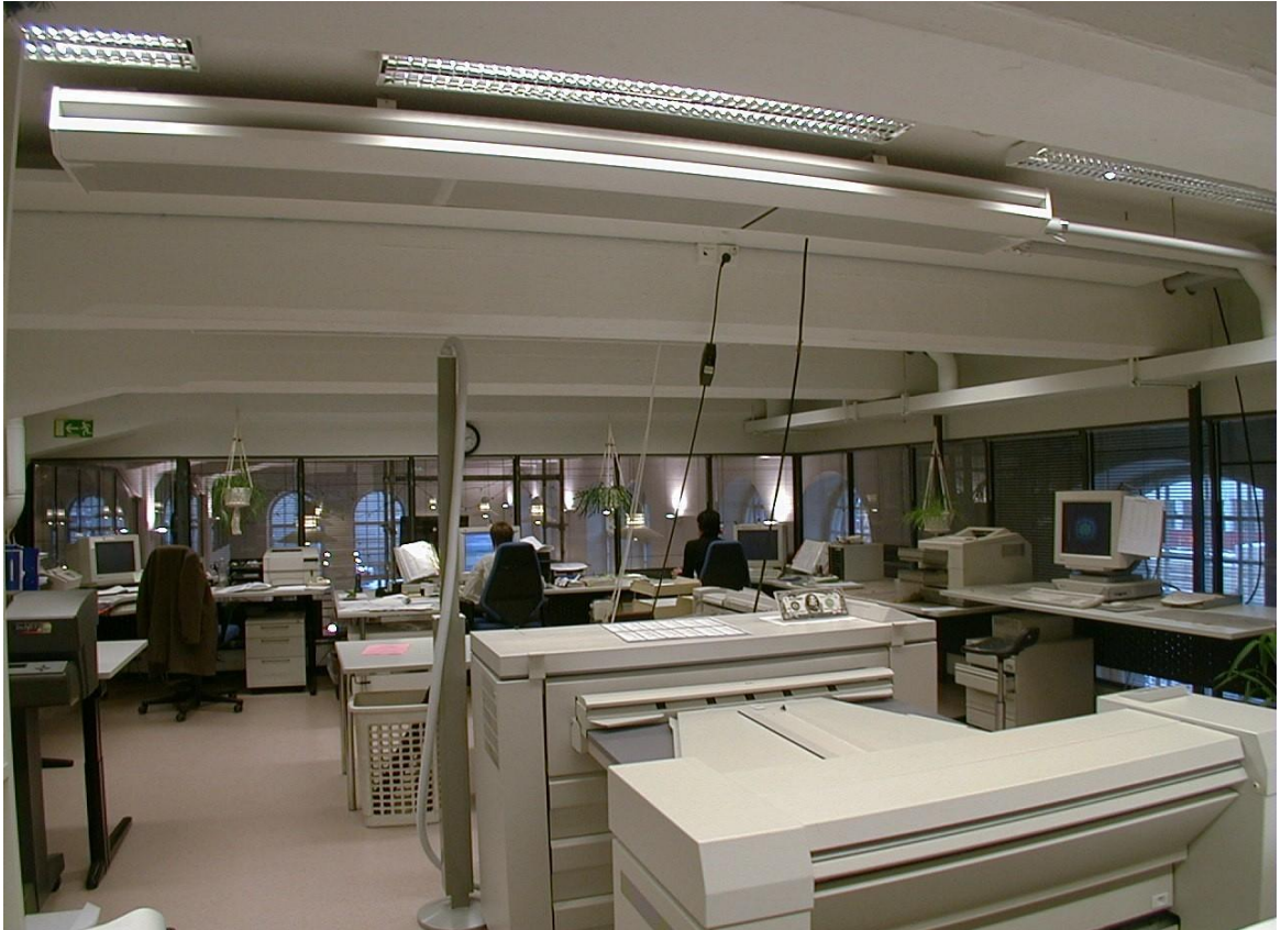
Kuva 10. Vanhan rakennuksen vanhat kattopalkit rajoittavat IV-kanavien vetoja. Huomaa kuvan oikeassa reunassa oleva erittäin matala suorakaidekanava.
