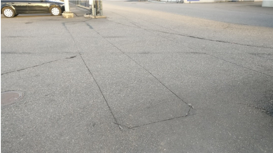
Kuva 4. Induktiosilmukka asennettu varastorakennuksen portille.
