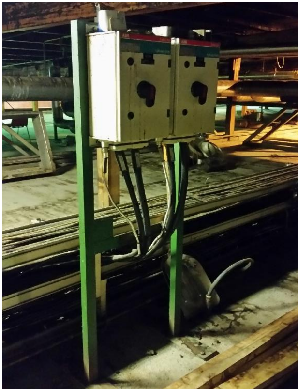
Kuva 12. Pehmokäynnistimille sopiva asennuspaikka olisi turvakytkimien vieressä välikatolla
