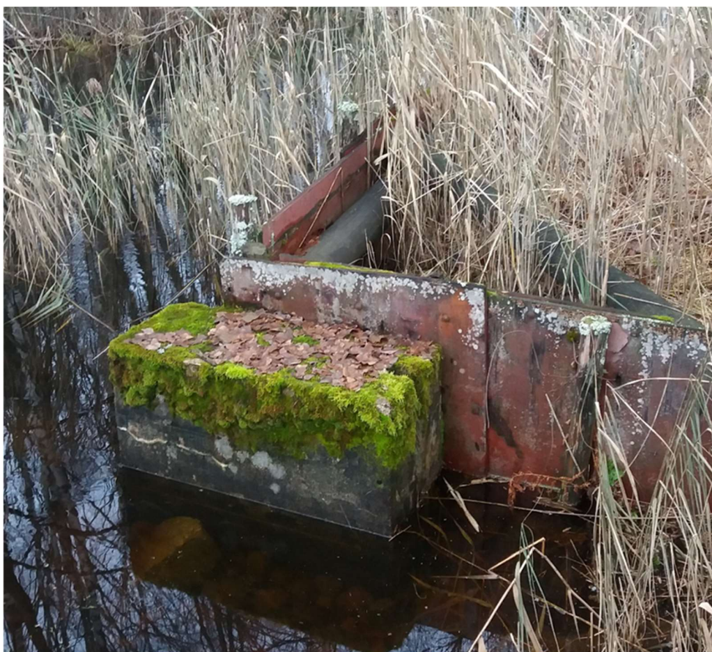
Kuva 13. Padon sivurakenteet. Puuosat ovat voimakkaasti lahonneet.
