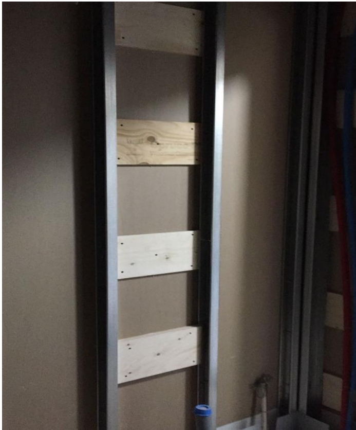
Kuva 9. Väliseinä levytetty toiselta puolelta ja vanerituet asennettu seinän sisään. As Oy Tampereen Konkari, 20.5.2018.
