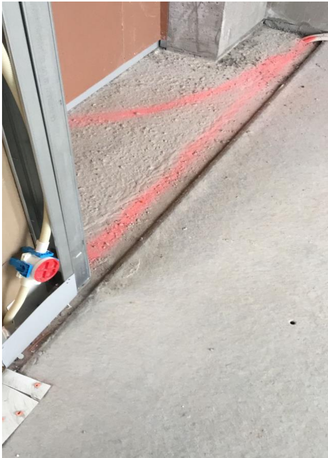
Kuva 21. Kylpyhuoneen raakavalu jäänyt vajaaksi ontelolaattojen yläpinnasta. As Oy Tampereen Konkari, 25.6.2018.
