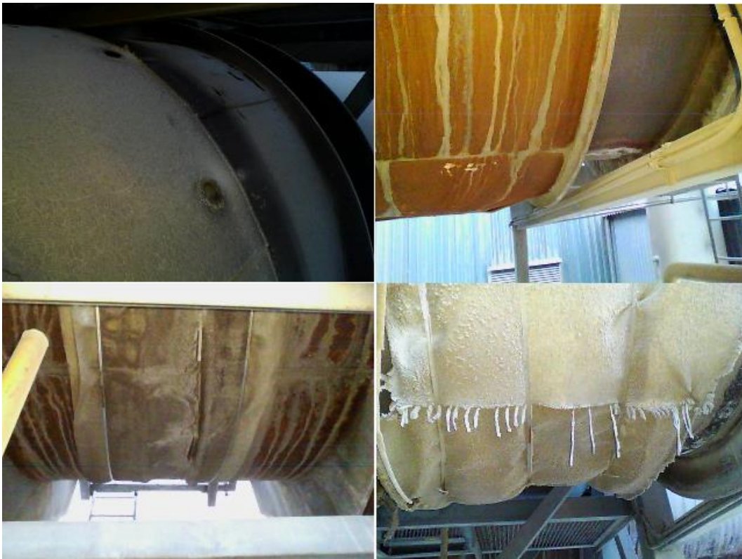
KUVA 6. Yläpuolella olevissa kuvissa on nähtävillä AOD:n primäärikanavassa limittäin olevilla mankeloiduilla levyillä korvattu palje P-13. Alhaalla vasemmalla on kuvattuna AOD:n sekundäärikanavan palje P-14. Oikealla alhaalla VKU:n primäärikanavan palje P-12.
