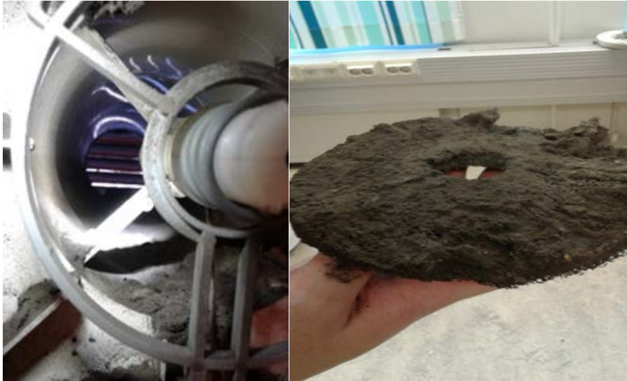
Kuva 5. Osa tuloilmaventtiileistä oli täysin tukkeutuneet hiilipölystä.
