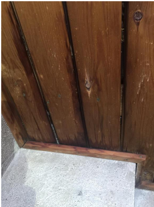
Kuvio 4. Saunan alakatossa veden valumajälkiä (Ravelin 2019).
