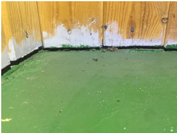
Kuvio 5. Epätiivis liittymä saunan lattiassa (Ravelin 2019).
