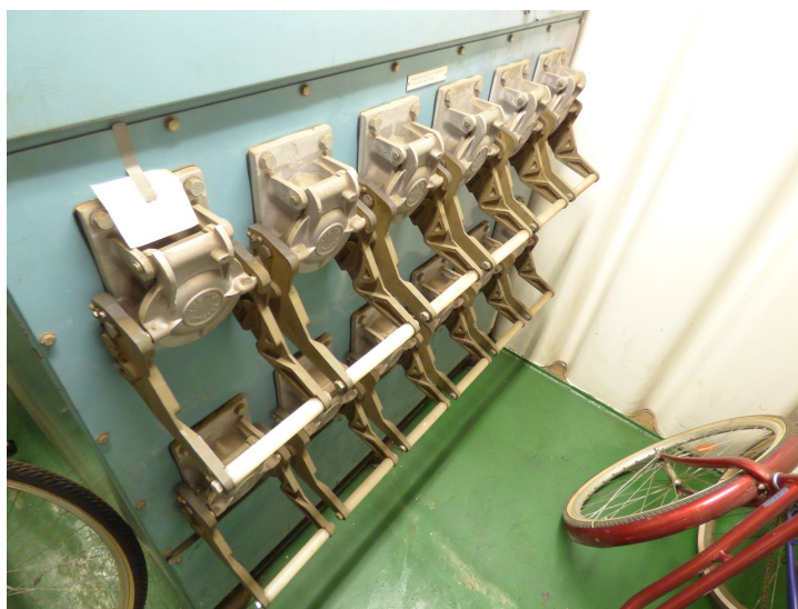
Figur 3. Den befintliga landströmsanslutningen i aktern.
